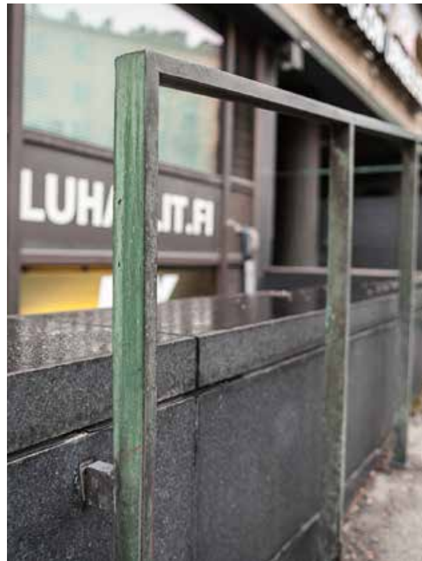
Alkuperäinen kaide Urheilutalon sisäänkäynnin luiskalla.
